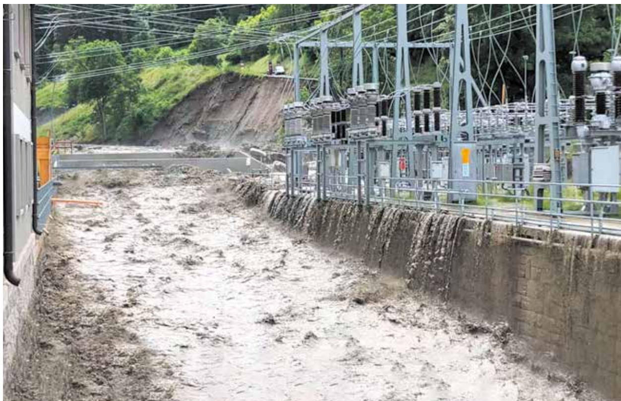
Die Navizence steigt bis auf die Höhe der Brücke, tritt über die Ufer und erreicht die Kupplungsstation der Hochspannungsschaltgruppe des Kraftwerks Vissoie der FMG.
