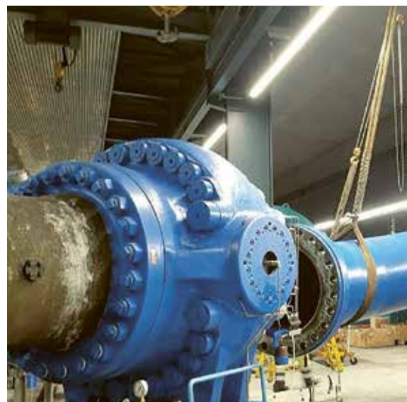
Inspection et suivi sur la pompe principale. Besichtigung und Nachbetreuung der Hauptpumpe.
