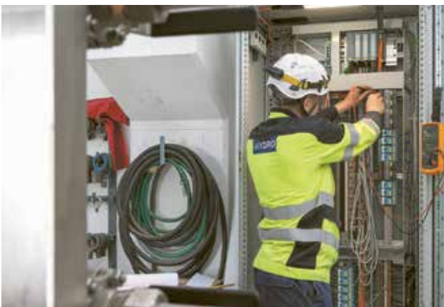
Die Teams von HYDRO installierten auch die Leittechnik der neuen Vorrichtungen.
