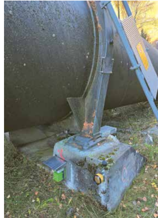
Smartpenstock : Des informations sont collectées en continu sur les conduites forcées, permettant de détecter tout mouvement ou déplacement dû aux aléas environnementaux, et ainsi de mieux les comprendre et anticiper les interventions.
