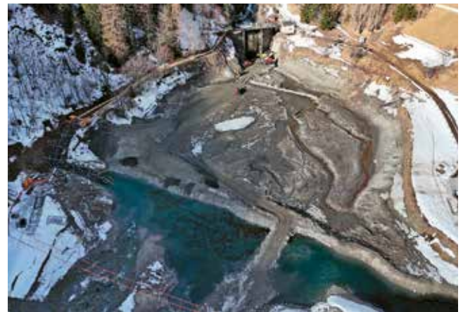
Vue générale du dispositif de gestion des eaux durant le chantier. Gesamtansicht des Dispositivs zur Wasserführung während der Bauarbeiten.
