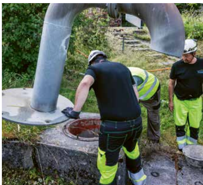
Die Mannlöcher des Zuleitungsstollens und der Leitung Nr. 2 zwischen der Schieberkammer und dem Kraftwerk wurden geöffnet, um den Inspektionsteams den Durchgang zu ermöglichen.
