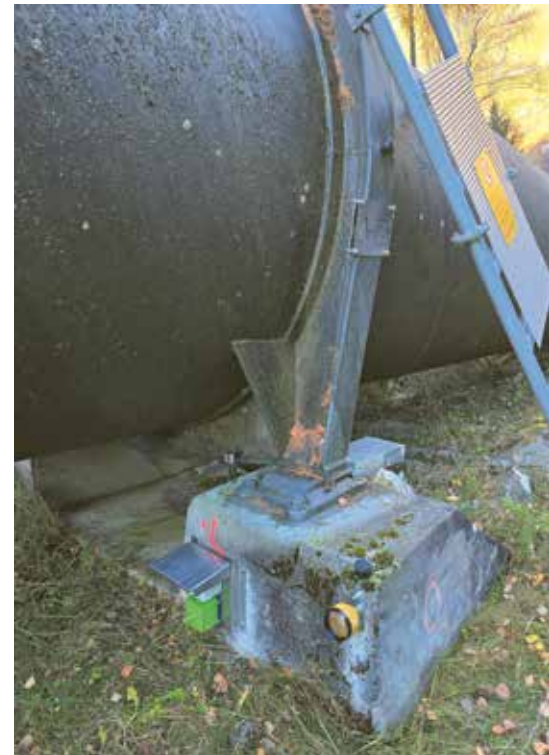
Smartpenstock: Es werden kontinuierlich Informationen zu den Druckleitungen gesammelt, die es ermöglichen, Bewegungen oder Verschiebungen aufgrund von Umwelteinflüssen zu erkennen, um diese besser zu verstehen und das Vorgehen zu antizipieren.
