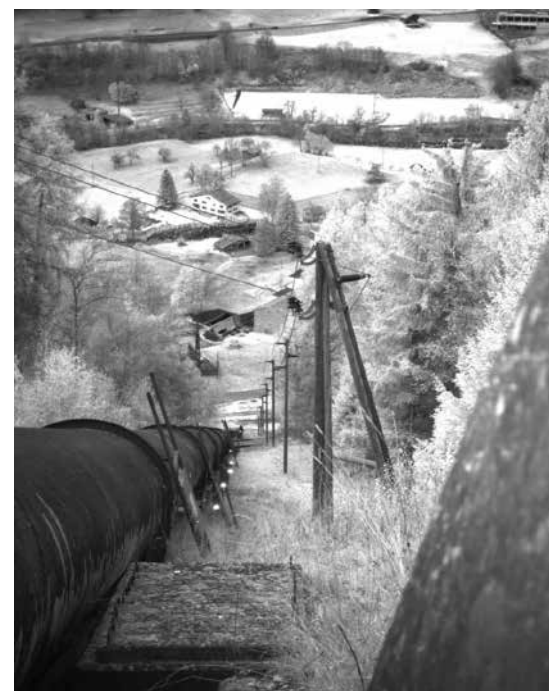
Smartpenstock : Un système de monitoring pilote a été déployé sur une section de conduite de l'aménagement d'Ernen appartenant aux FMV. Il utilise des marqueurs réfléchissants et une station de mesure avec caméra pour détecter et quantifier les déplacements.
