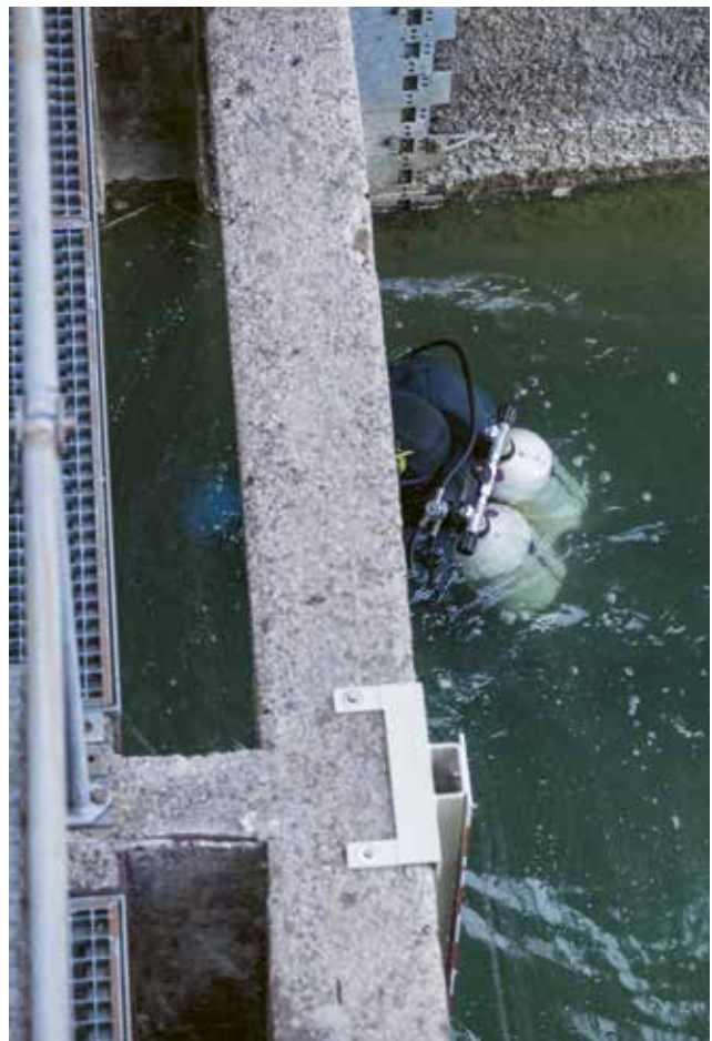
Ein Taucher wird eingesetzt, um die Dammbalken (provisorische Dämme) anzubringen, die Schieberführungen zu reinigen und zu kontrollieren und so die Wasserdichtigkeit des Einlaufschiebers zu gewährleisten.
