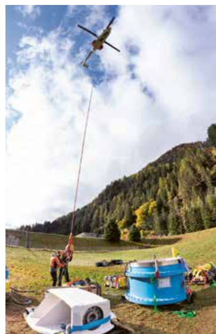
Les transports hélicoptérés ont nécessité une organisation et une coordination rigoureuses. Ici, l'hélicoptage de la nouvelle vanne papillon de Tsarmette avec un Super Puma.
