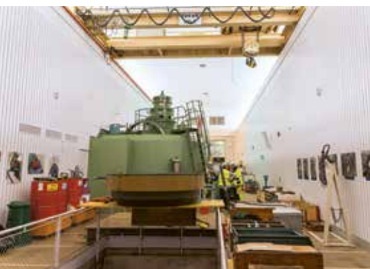
La salle des machines, en caverne, de la centrale des Clées.
