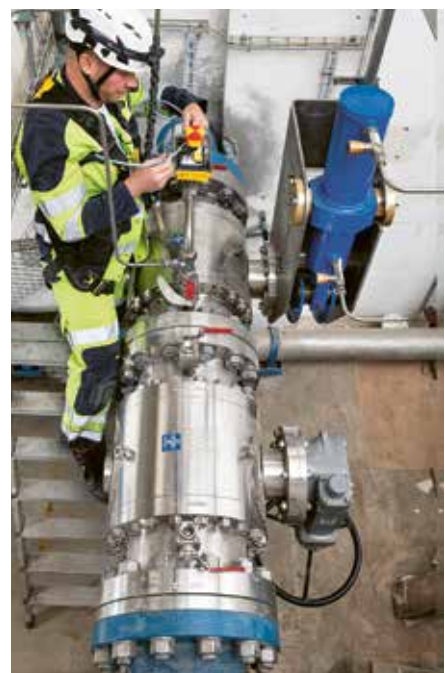
Verkabelung und Anschluss der neuen Schieber 7a/b durch das Personal der GEH Mottec.
