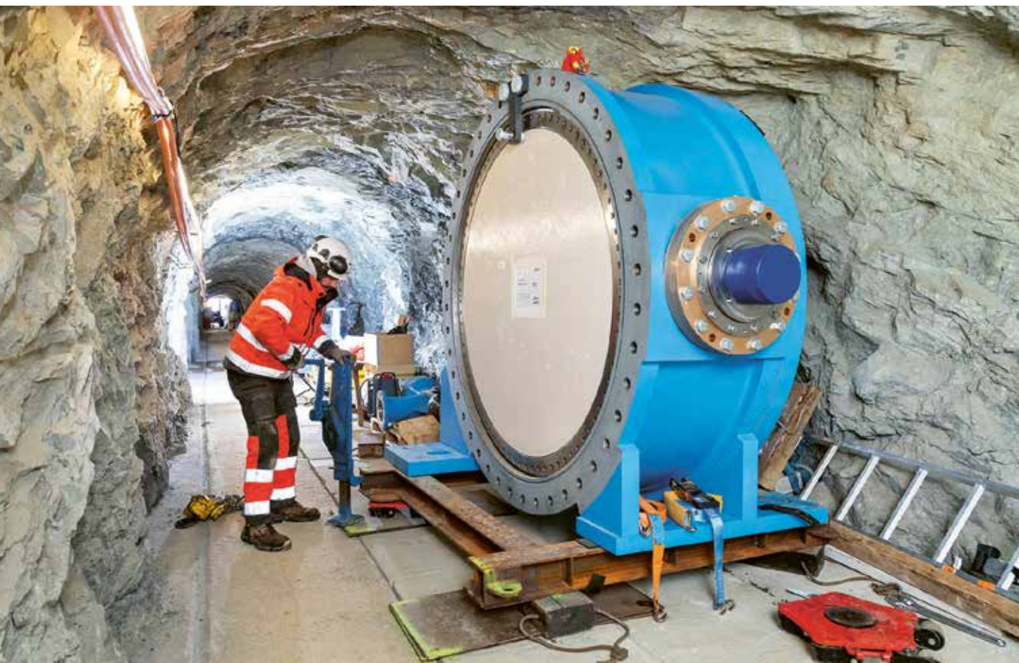
Manutention de la nouvelle vanne papillon dans la galerie d'accès à la chambre des vannes à Moiry.
