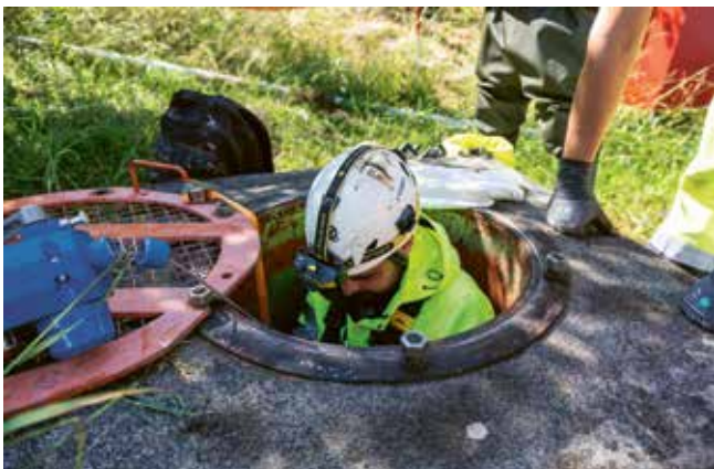
Les trous d'hommes de la galerie d'amenée et de la conduite n° 2, entre la chambre des vannes et la centrale, ont été ouverts pour permettre le passage des équipes d'inspection.
