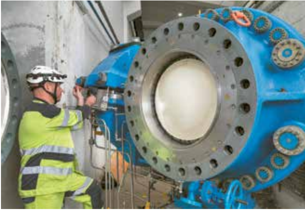
Verkabelung und Anschluss des Schiebers 6, der von unseren Zentralen Werkstätten in Martigny vollständig revidiert wurde.
