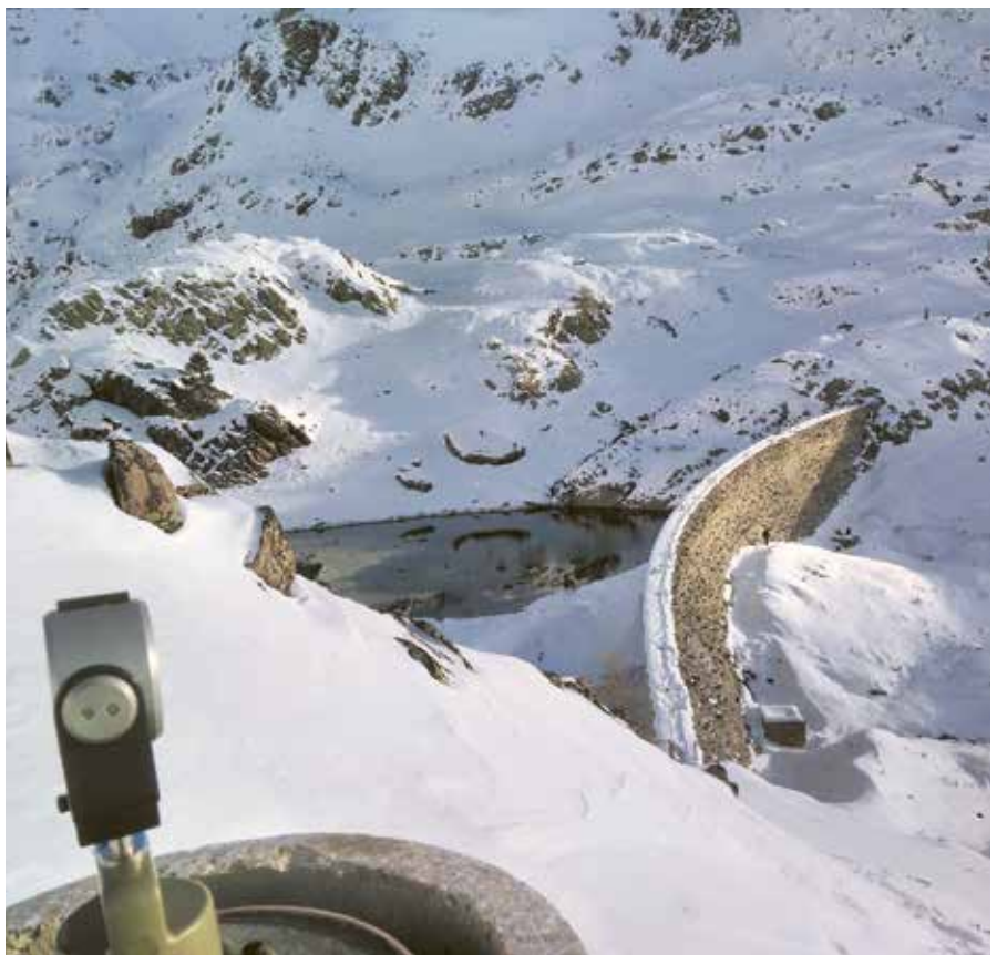
Différents instruments de géomatique permettent de mesurer les déplacements tridimensionnels de repères sur l'ouvrage.
