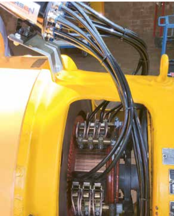
An den Kohlebürstenhalterungen des Kollektors und an den Rotorschleifringen wurde ein System zur Kohlenstaubabsaugung installiert.
