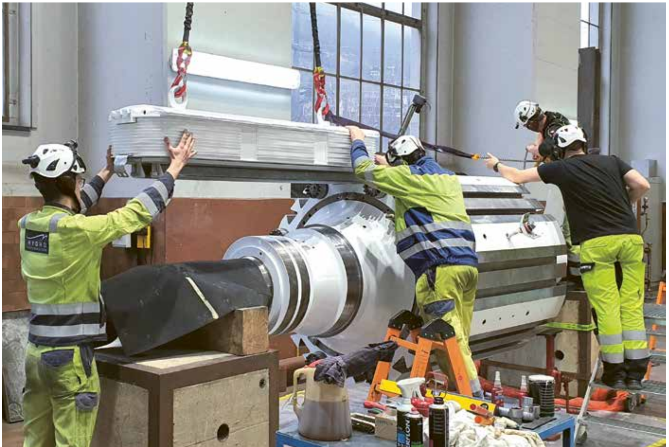
Nach der Revision wurden die Pole wieder installiert.
