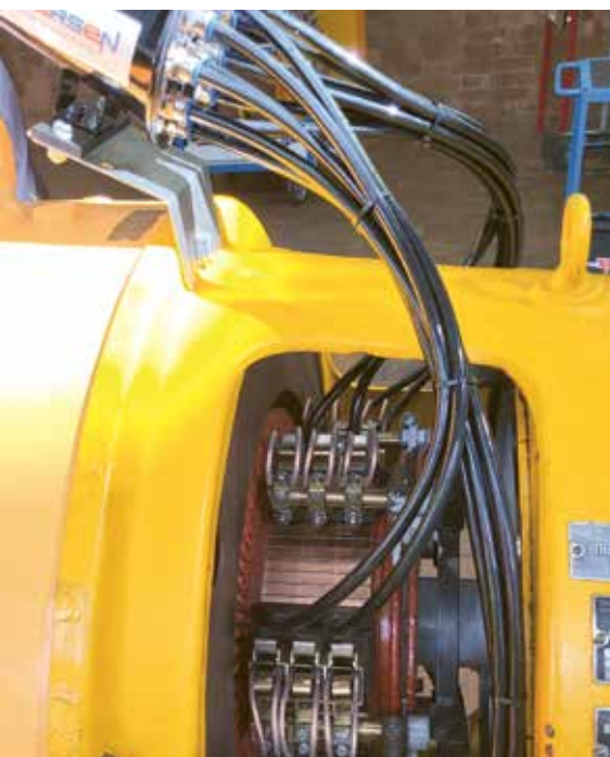
Un système d'aspiration des poussières de charbon a été installé sur les supports porte-charbons du collecteur d'excitatrice et sur les bagues collectrices du rotor.
