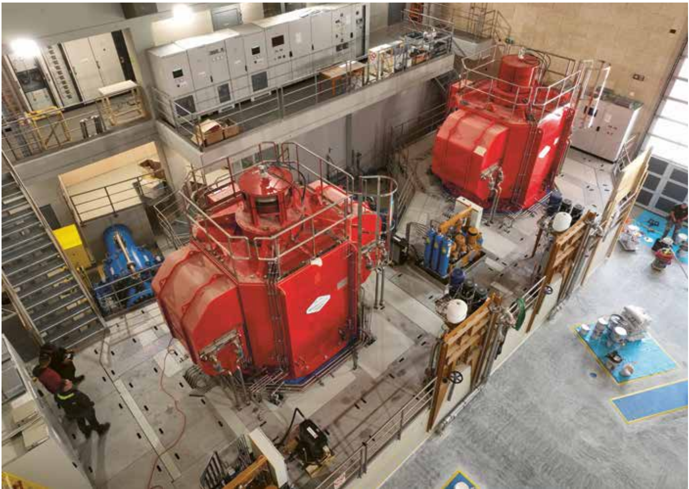
Vue intérieure de la nouvelle centrale avec les deux groupes, les armoires de contrôle-commande correspondantes ainsi qu'une partie BOP au 1 er étage (23 juillet 2023).
