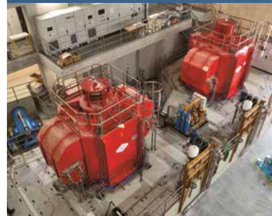
Innenansicht des neuen Kraftwerks mit den beiden Gruppen, den dazugehörigen Leittechnikschränken sowie einem Teil der BOP im Obergeschoss (23. Juli 2023).
