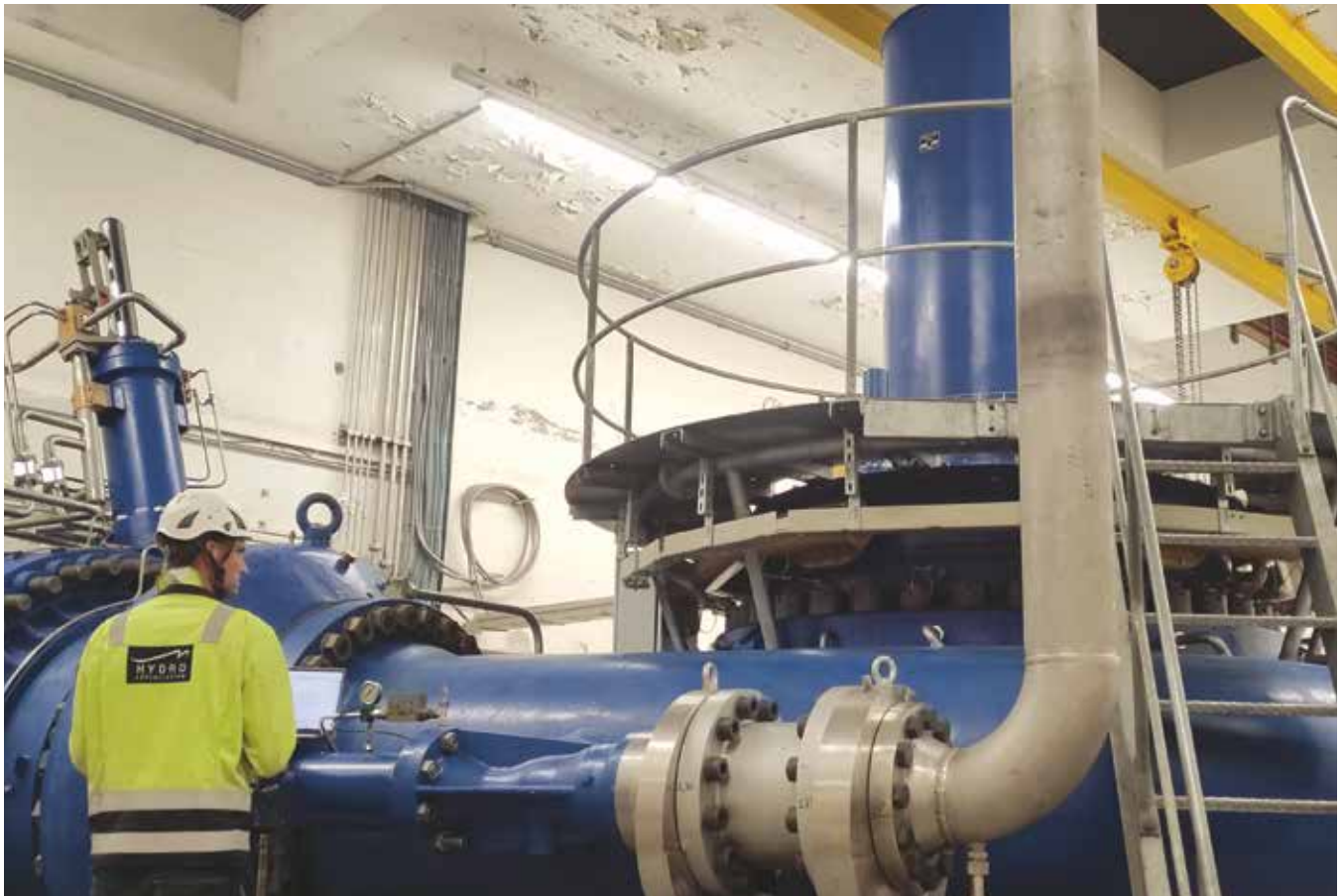
Test de la vanne pompe, dernière partie principale ayant été mise en service sur le complexe de Châtelard.
