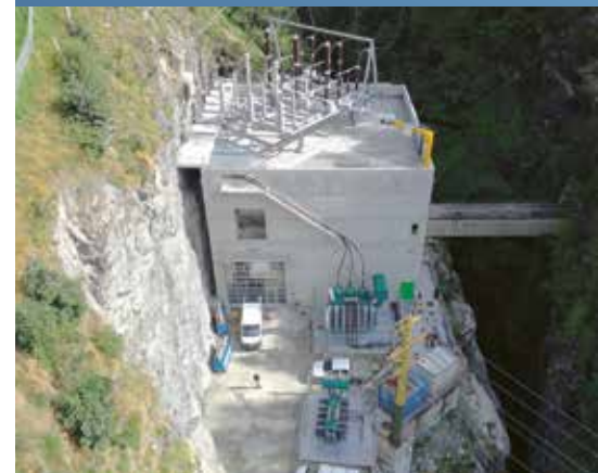
Aussenansicht des Kraftwerks mit den neuen 220-kV und 16-kV Transformatoren sowie der neuen 220-kV Freiluftschaltanlage von Swissgrid (23. Juli 2023).
