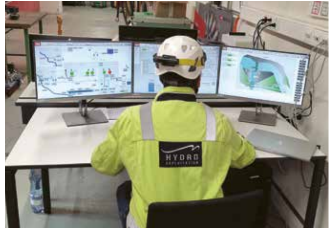
Programmation du superviseur et de l'archivage de la centrale.
