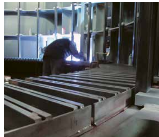
Februar 2023: Vorbereitung des Statorkäfigs der neuen Gruppe 1. Nach einer genauen Ausrichtung werden die Statorstäbe für das Statorpaket vor Ort verschweisst.
