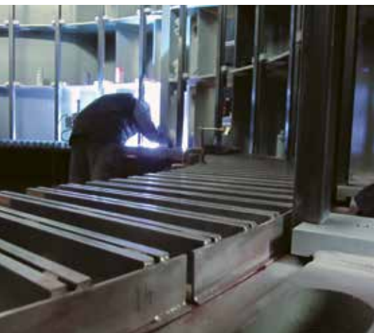
Février 2023 : préparation de la cage statorique du nouveau groupe 1. Après un alignement précis, les barres qui permettront l'empilement du stator sont soudées sur site.
