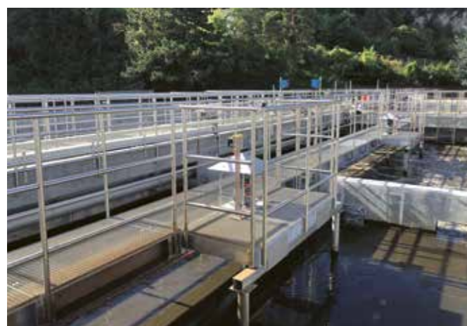
A la STEP de Chandoline, HYDRO a réalisé la programmation des automates, de la supervision, des écrans tactiles et la mise en service de tous ces éléments.
