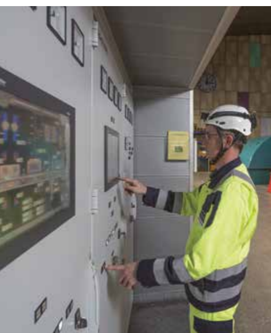
Steuerung der Maschine des Kraftwerks Veytaux (FMHL) während der Kontrolle der elektrischen Schutzvorrichtungen bei den Primärversuchen.
