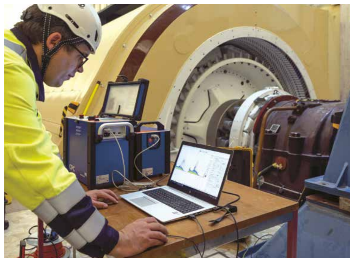
Afin d'améliorer le suivi des installations, une série de tests diagnostiques ont été développés, appliqués aux machines, aux transformateurs ou aux postes électriques. Ici, des mesures de décharges partielles sont effectuées sur un alternateur de la centrale de Nendaz (DiamHEX).
