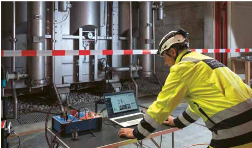
Ende 2021 wurde HYDRO Exploitation damit beauftragt, einen Pumpbetrieb mit sechs anstatt wie bisher mit fünf Maschinengruppen in einer technischen Analyse zu überprüfen. Diese Betriebsart wurde bei Tests in der Nacht auf den 22. Dezember validiert. So konnten zudem die Marktpreise voll ausgenutzt werden.
